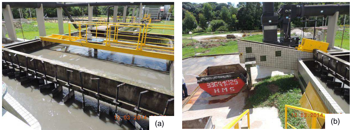
FIGURA 6 – SISTEMA DE REMOÇÃO DE AREIA DA ETE SANTA QUITÉRIA: (a) DESARENADOR COM LIMPEZA DE FUNDO MECANIZADA E (b) TRANSPORTADOR INCLINADO E CAÇAMBA DE AREIA
