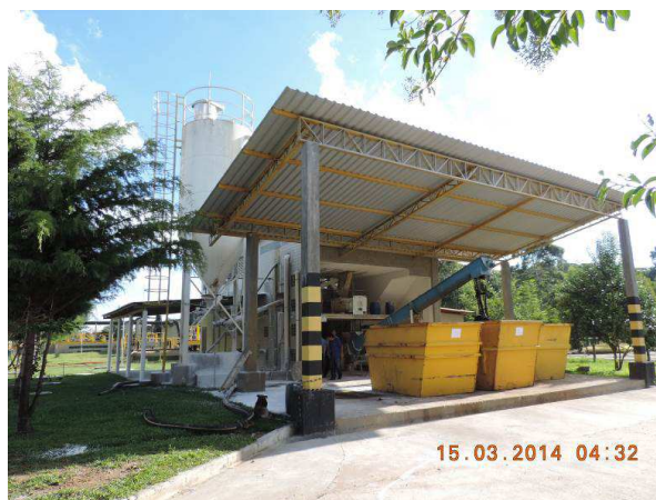
FIGURA 10 – SISTEMA DE DESAGUAMENTO E HIGIENIZAÇÃO DE LODOS DA ETE SANTA QUITÉRIA
