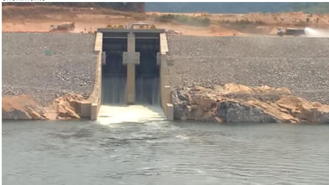
Figura 12 – Vertedouro do Canal de Derivação da UHE Belo Monte durante seu enchimento
