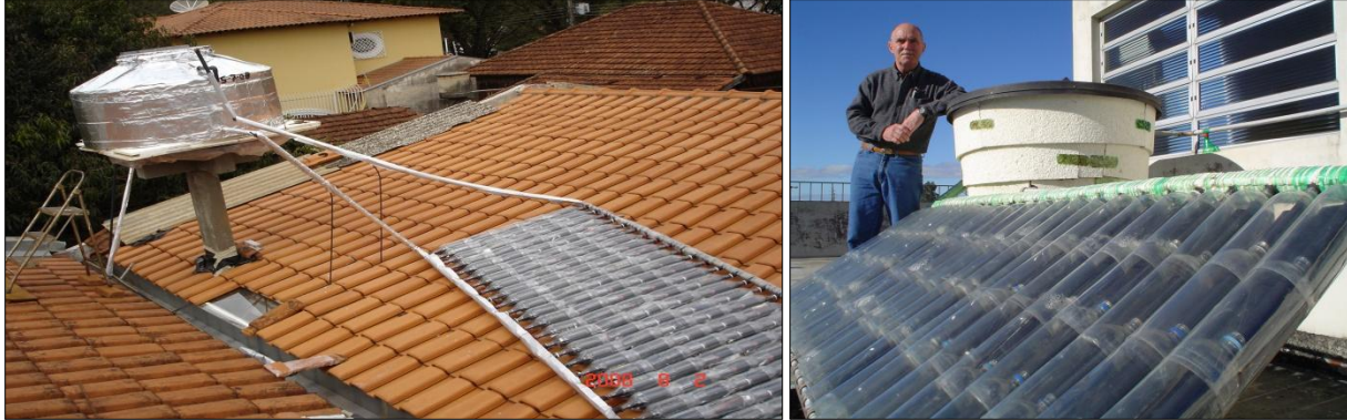
FIGURA 30: GARRAFAS PET SE TRANSFORMAM EM AQUECEDOR SOLAR FONTE: http://www.infoescola.com/ecologia/aquecedor-solar-de-material-reciclado
