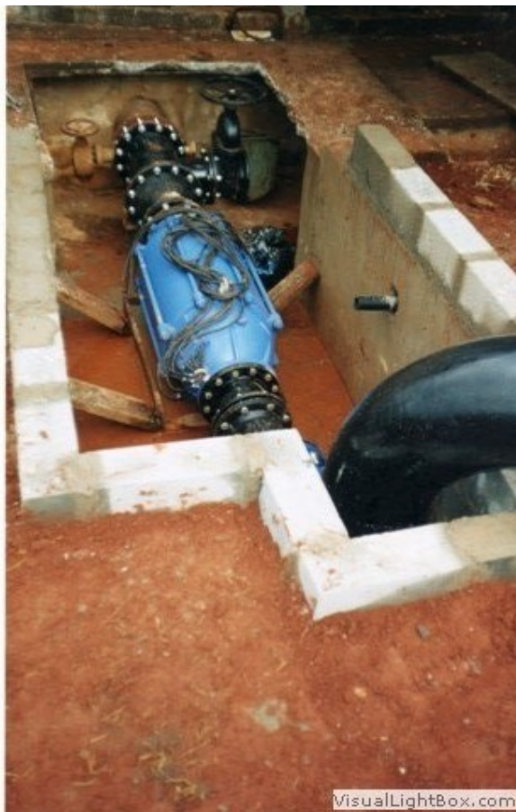
FIGURA 3 - BOOSTER FONTE: 3CCONSTRUTORA (2014)
