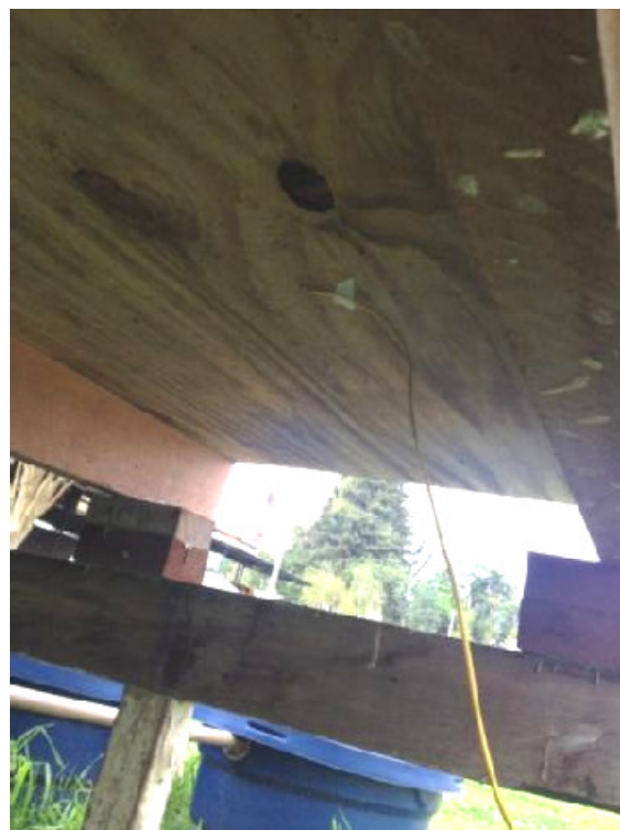
figura 83 - sensor instalado para medição superficial inferior Fonte: A autora (2014)
