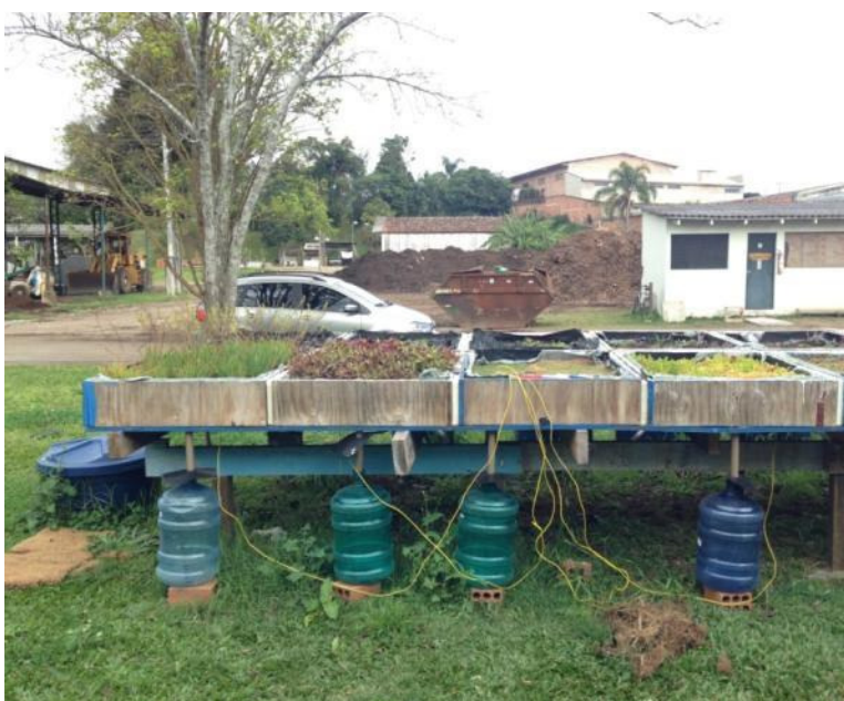
figura 78 - coletores de água da chuva instalados Fonte: A Autora (2014)
