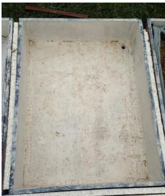
figura 69 - Módulo impermeabilizado - pluviômetro Fonte: A Autora (2014)
