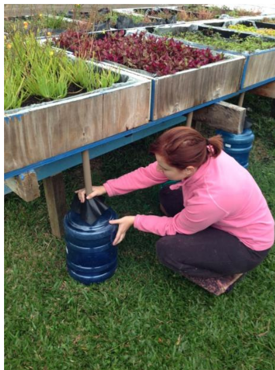
figura 46 - Instalação do sistema de coleta de água da chuva Fonte: A autora (2014)
