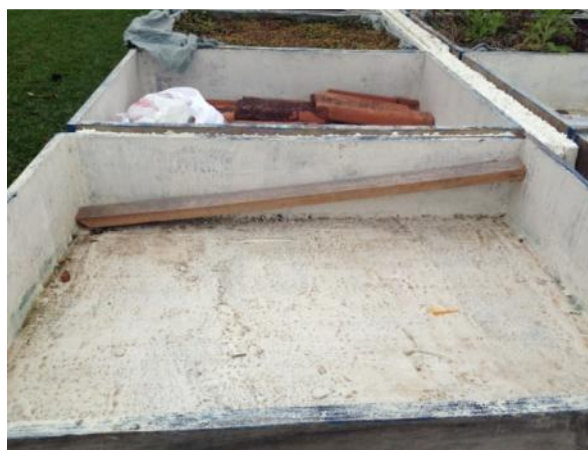
figura 74 - Fixação de caibro para apoio da telha de fibrocimento Fonte: A Autora (2014)
