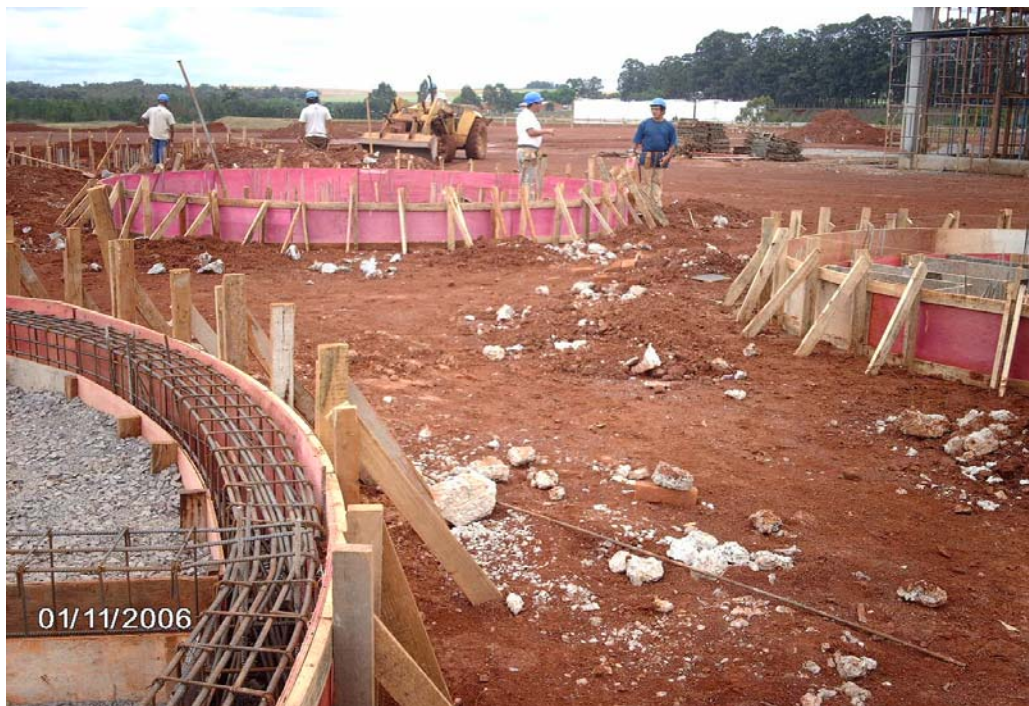
Construção da Usina de Biodiesel BS-Bios em Passo Fundo/RS. Fotografia e Acervo do Autor.
