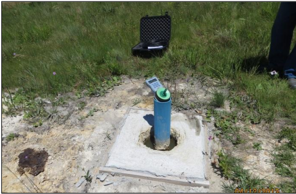
FIGURA 15 – POÇO DE MONITORAMENTO DA QUALIDADE DA ÁGUA SUBTERRÂNEA PM05. 10,70 METROS DE PROFUNDIDADE. LOCALIZAÇÃO UTM: W 596043; S 7221536. (DATUM SAD69)
