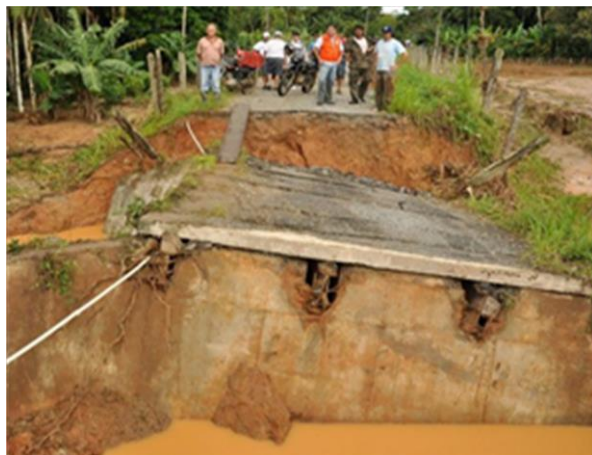
FIGURA 5: Queda da ponte na comunidade. FONTE: Arquivo da Prefeitura.
