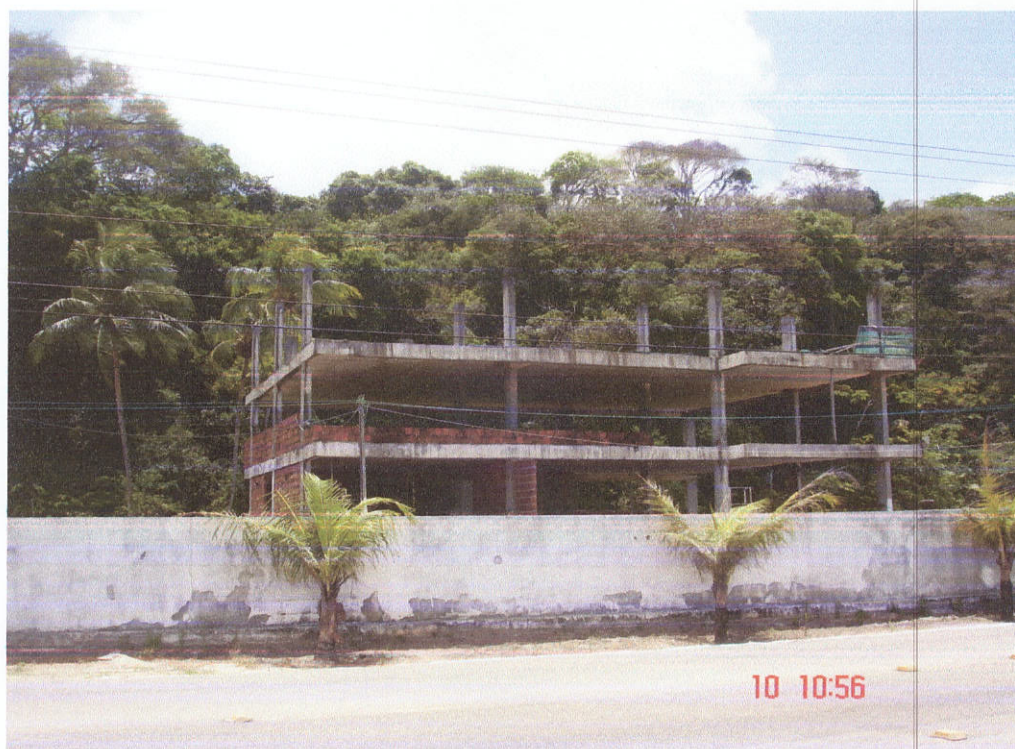
Fig. 25: Obras paralisadas do Marina's Ocean, no sopé da Falésia inativa do Cabo Branco Fonte: Arquivo Mariana Queiroz
