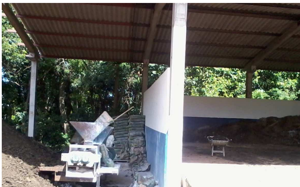
FIGURA 11 - MAROMBA UTILIZADA PARA HIGIENIZAÇÃO DE LODO DESAGUADO EM LEITO DE SECAGEM, UGL OURO VERDE, FOZ DO IGUAÇU, PR FONTE: O autor (2013)
