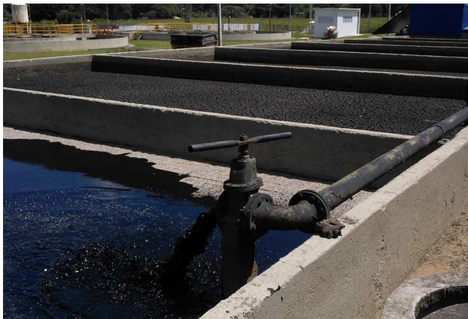
FIGURA 9 - LEITOS DE SECAGEM, ETE CAMBUÍ, CAMPO LARGO, PR FONTE: O autor (2014)
