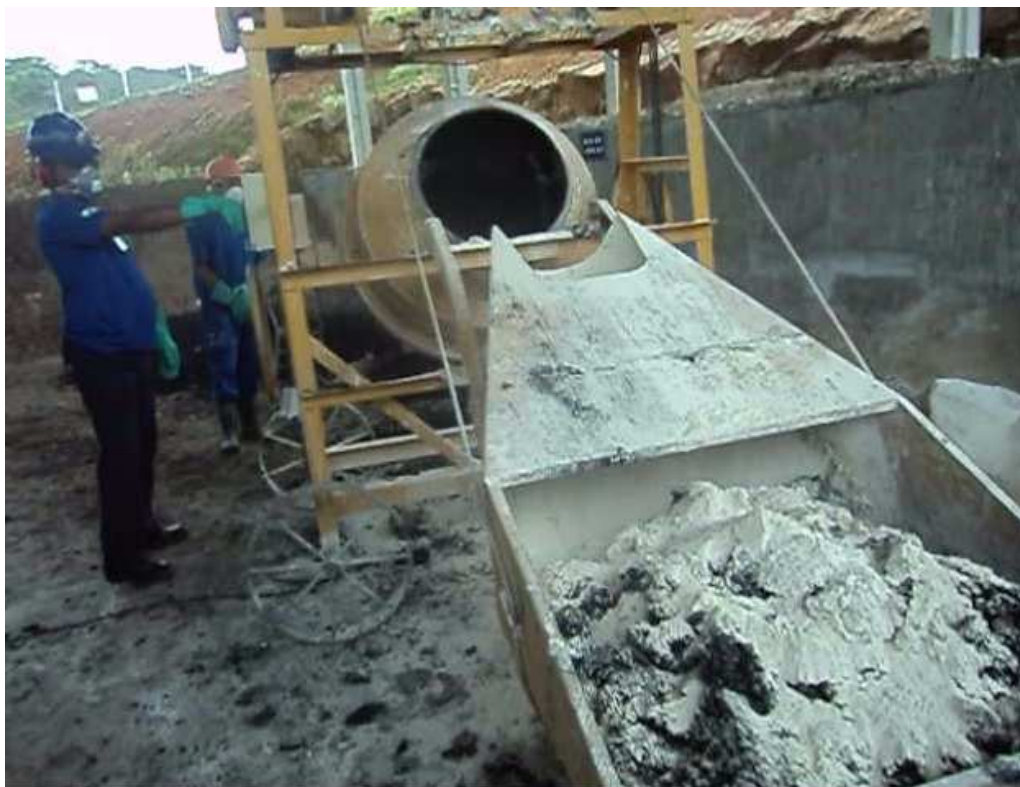
FIGURA 10 - BETONEIRA UTILIZADA PARA HIGIENIZAÇÃO DE LODO DESAGUADO EM LEITO DE SECAGEM, UGL VASSOURAL, GUARAPUAVA, PR FONTE: Marques, C. J. (2012)
