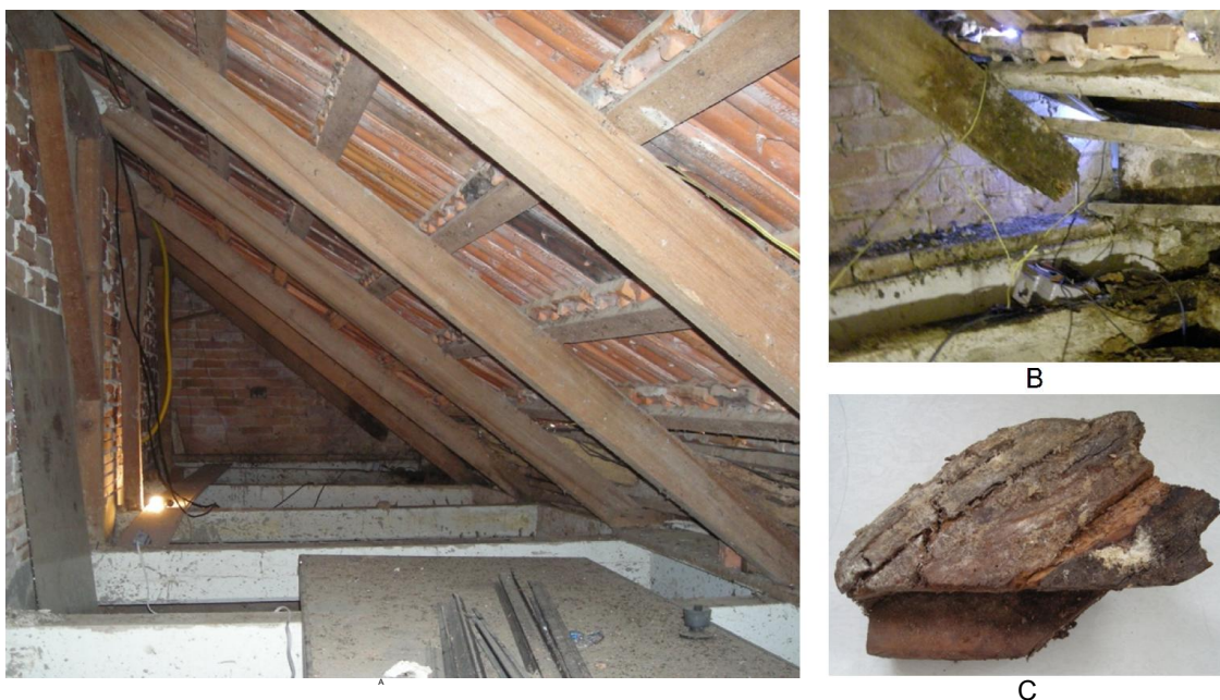
FIGURA 68 – VISTA GERAL DAS TRAMAS DO LADO A (A), LESÃO NO CAIBRO CD8 (B), PEÇA QUE RESTOU DO CAIBRO CD8 (C).
