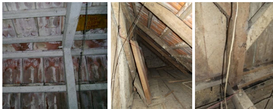
A B C FIGURA 40 – ESTRUTURA DO TELHADO DA CASA MACZAK (A), PONTALETE E MÃOS-FRANCESAS (B)
