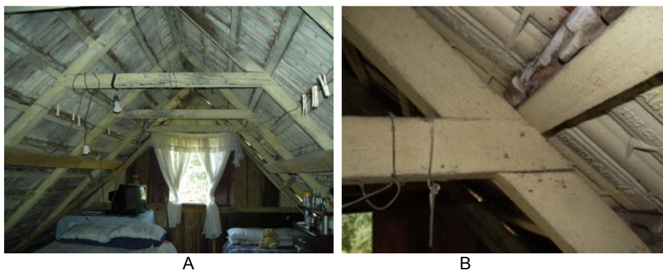
FIGURA 39 – ESTRUTURA DO TELHADO DA CASA CETNARSKI (A), ENCAIXE DO TIPO MEIA-MADEIRA (B).
