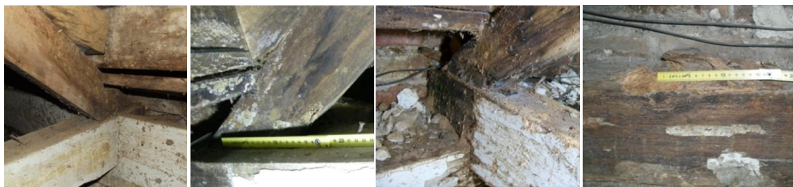
FIGURA 71 – MANCHAS, SINAIS DE UMIDADE (A), FUNGO EMBOLORADOR (B), PODRIDÃO PARDA, CORPOS FRUTÍFEROS NA LATERAL (C), PODRIDÃO MOLE NA BASE (D).
