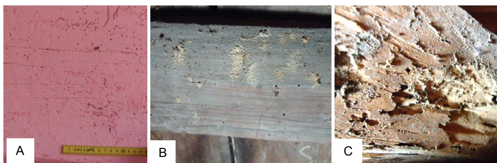
FIGURA 79 – ORIFÍCIOS DE EMERGÊNCIA E GALERIAS DE Anobiinae (Coleoptera: Ptinidae), TRONCOS EXTERNOS DA CASA GROCHOCKI (A), ORIFÍCIOS DE EMERGÊNCIA COM RESÍDUOS FINOS NO CAIBRO DO SÓTÃO (B), GALERIAS LISAS COM RESÍDUO GRANULAR DE ISOPTERA (C). FONTE: MACARI (2012), KOVALSKI (2013).
