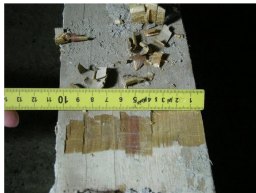
FIGURA 52 – AMOSTRA FEITA NA VIGA COM A RETIRADA DE LÂMINA DE MADEIRA.
