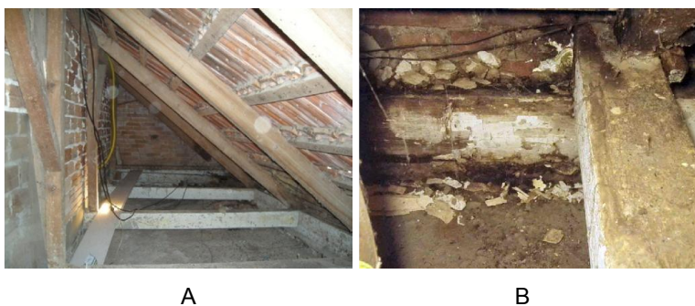
FIGURA 77 – VISTA GERAL DO SÓTÃO DA CASA DA CULTURA, LADO A (A) DETALHE DAS VIGAS DE MADEIRA DETERIORADAS POR FUNGOS (B).
