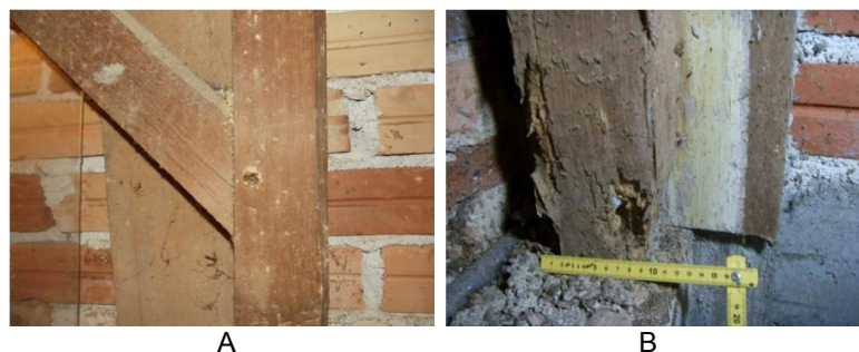
FIGURA 70 – ORIFÍCIOS DE EMERGÊNCIA E RESÍDUOS DE INSETOS (A), GALERIAS DE COLEÓPTEROS E PERDA DA SEÇÃO NA BASE DO PENDURAL PE9 (B).
