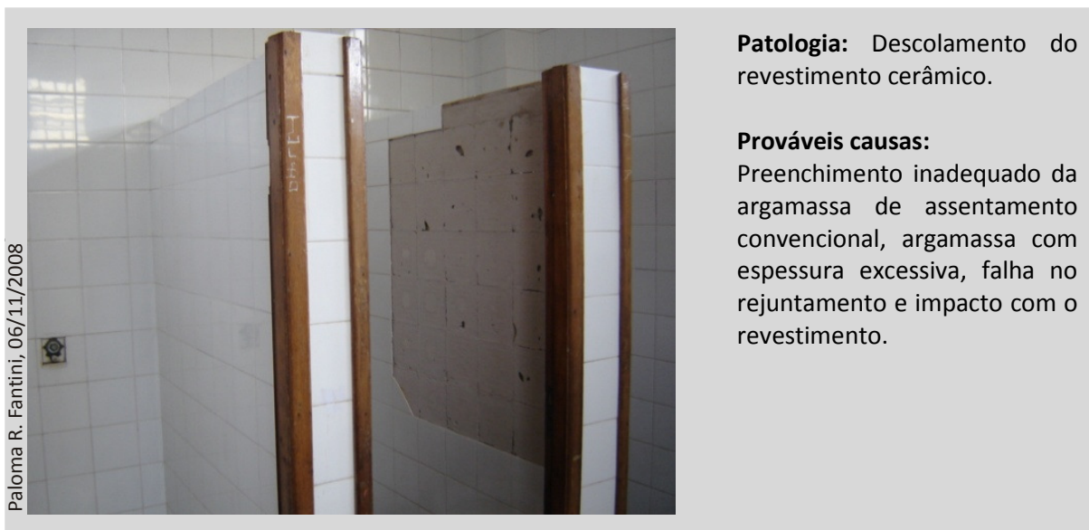
Figura 23: Descolamento do revestimento cerâmico – parede do banheiro
