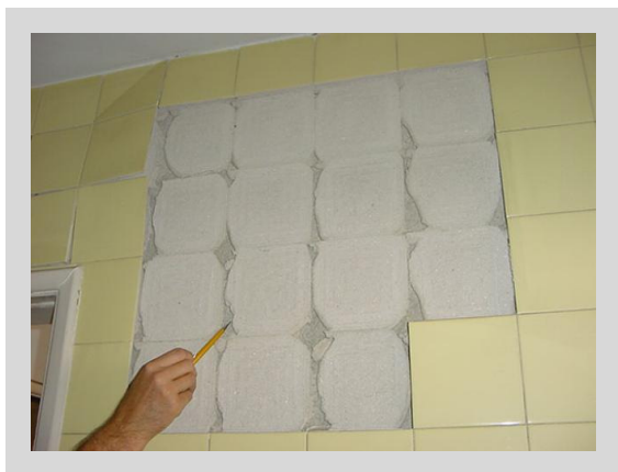
Figura 10: Assentamento inadequado do revestimento – indicação dos vazios Fonte: Thomaz (s.d.)
