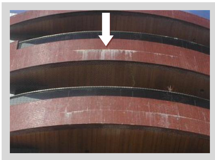
Figura 17: Eflorescência na fachada da edificação Fonte: Padilha Jr. (2007)
