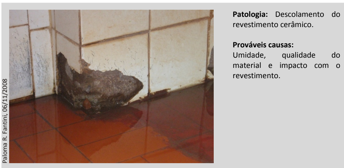
Figura 30: Detalhe do descolamento – parede do mictório (banheiro masculino)
