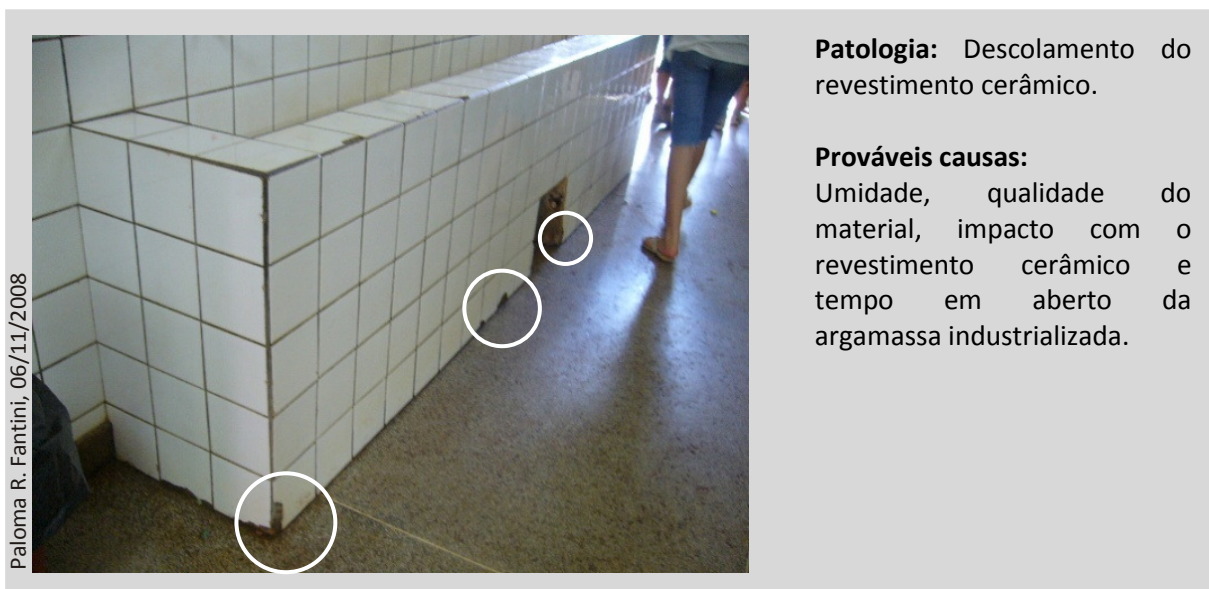
Figura 36: Descolamento do revestimento cerâmico – parede do bebedouro
