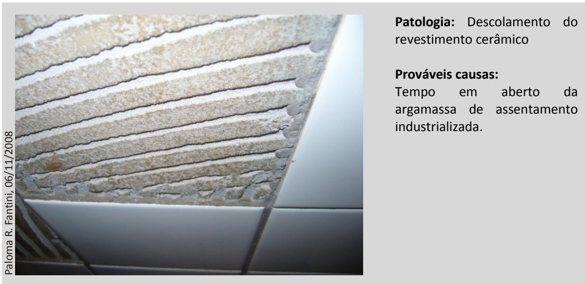
Figura 35: Detalhe do descolamento cerâmico – parede próxima ao bebedouro
