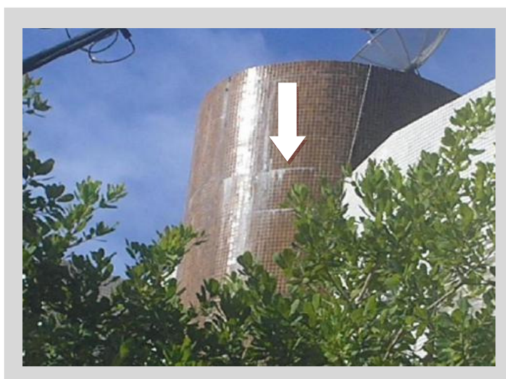
Figura 18: Eflorescência nas pastilhas cerâmicas Fonte: Padilha Jr. (2007)
