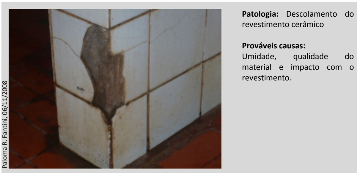
Figura 31: Detalhe do descolamento – quina do mictório (banheiro masculino)
