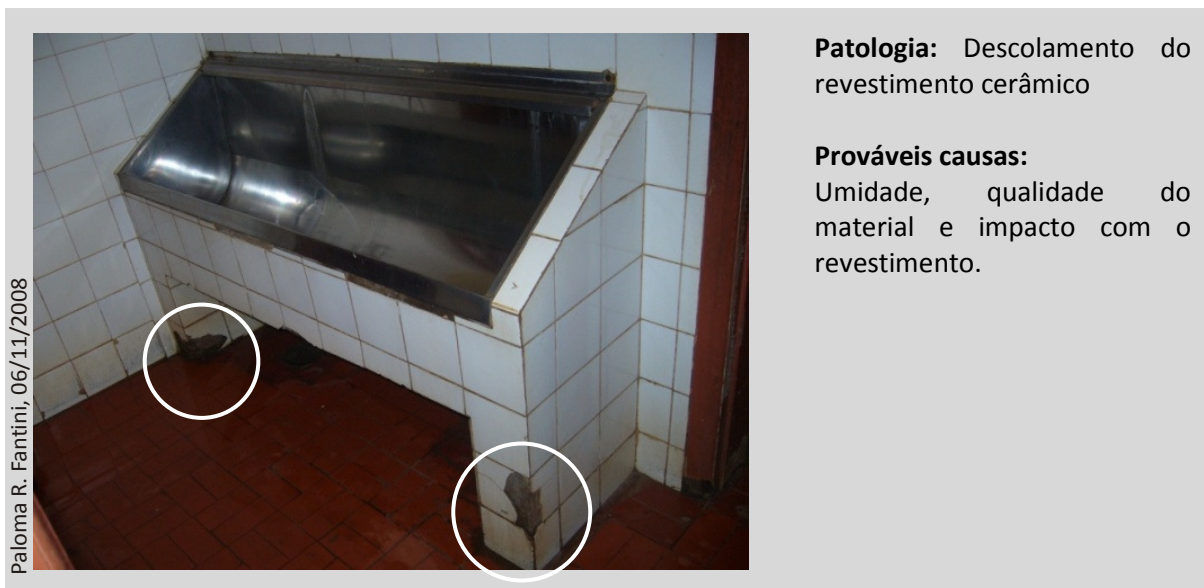
Figura 29: Descolamento do revestimento cerâmico – mictório (banheiro masculino)
