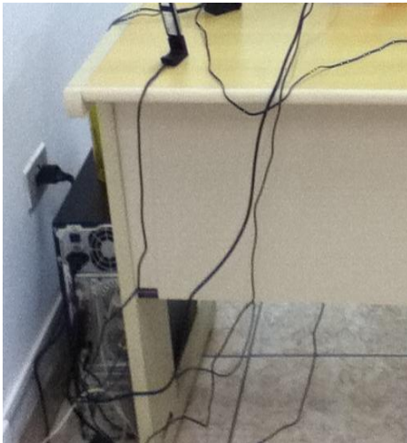
Fig. 23 - Cabos e fios (antes do 5S)
