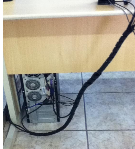
Fig. 24 - Cabos e fios (depois do 5S)
