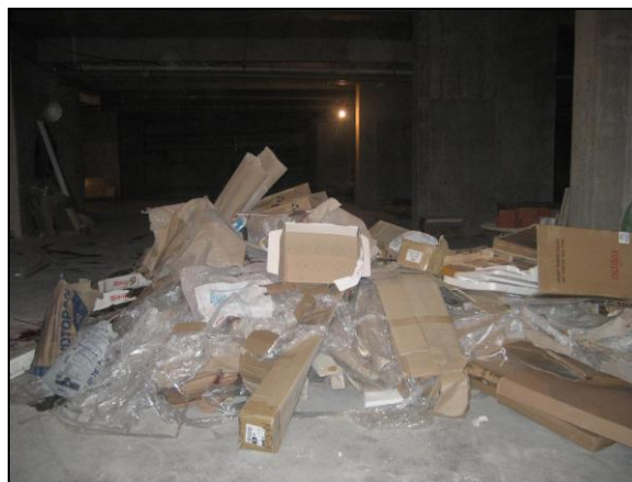
FIGURA 41 – RESÍDUOS MISTURADOS NO MEIO DA OBRA (CONSTRUTORA 13).
