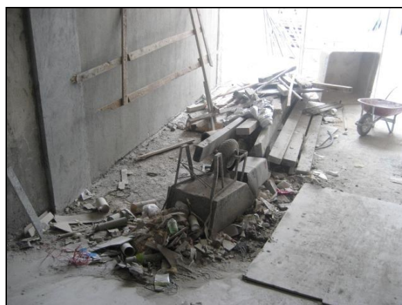
FIGURA 33 – DESPÉRDICIO DE MATERIAL E DESORGANIZAÇÃO NA OBRA (CONSTRUTORA 11).
