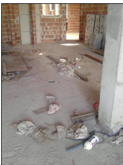
FIGURA 20 – RESÍDUOS EM TODA A OBRA (CONSTRUTORA 7). FONTE: Foto da autora.
