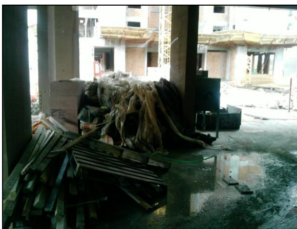
FIGURA 24 – RESÍDUOS MISTURADOS EM TODA A OBRA (CONSTRUTORA 9).
