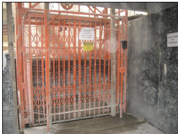
FIGURA 57 – ELEVADOR DE OBRA. GERAÇÃO DE RESÍDUOS PERIGOSOS (CONSTRUTORA 17). FONTE: Foto da autora.
