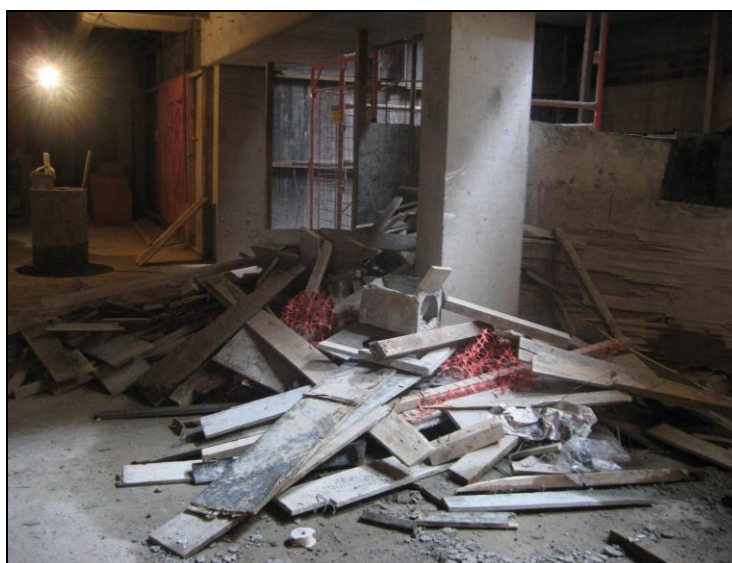
FIGURA 21 – RESÍDUOS MISTURADOS EM LOCAL SEM IDENTIFICAÇÃO (CONSTRUTORA 7). FONTE: Foto da autora.
