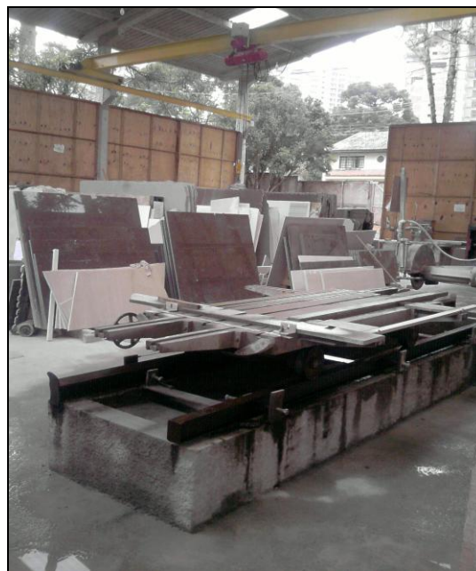
FIGURA 23 – MATERIAIS DIVERSOS EM GRANDE QUANTIDADE (CONSTRUTORA 8). FONTE: Foto da autora.
