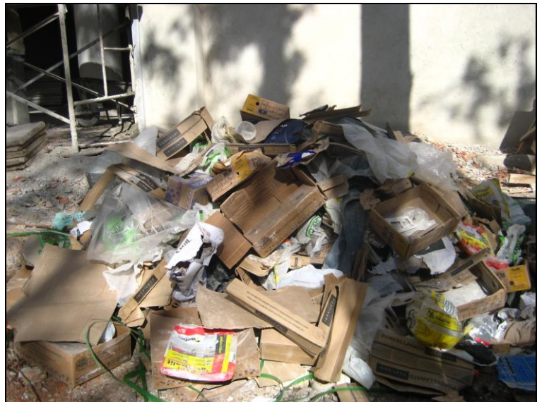
FIGURA 5 – DETALHE RESÍDUOS MISTURADOS (CONSTRUTORA 2). FONTE: Foto da autora.
