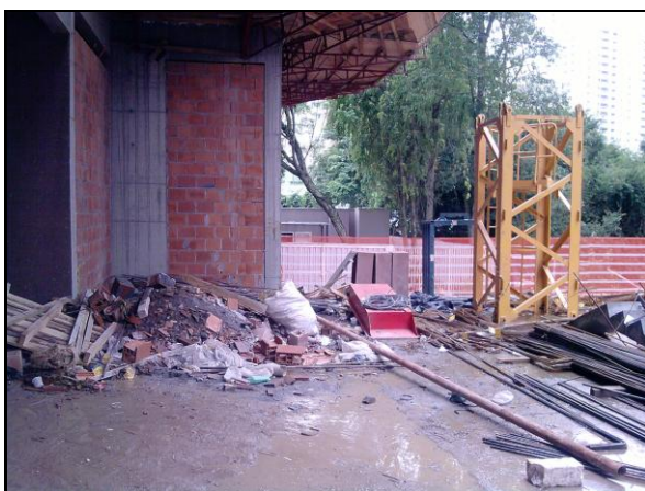
FIGURA 26 – DESORGANIZAÇÃO NA OBRA (CONSTRUTORA 9).
