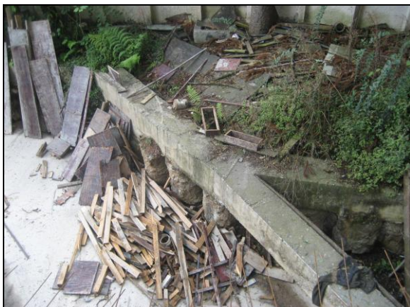
FIGURA 38 – DESORGANIZAÇÃO E LOCAL SEM IDENTIFICAÇÃO PARA RESÍDUOS (CONSTRUTORA 13).
