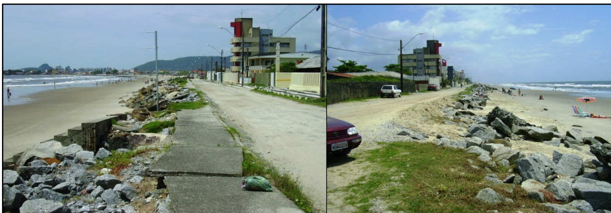
FIGURA 4.17 - Destruição da Avenida Beira Mar pela erosão, Balneário Flamingo Fonte: Fotos do autor, 11/12/2010.
