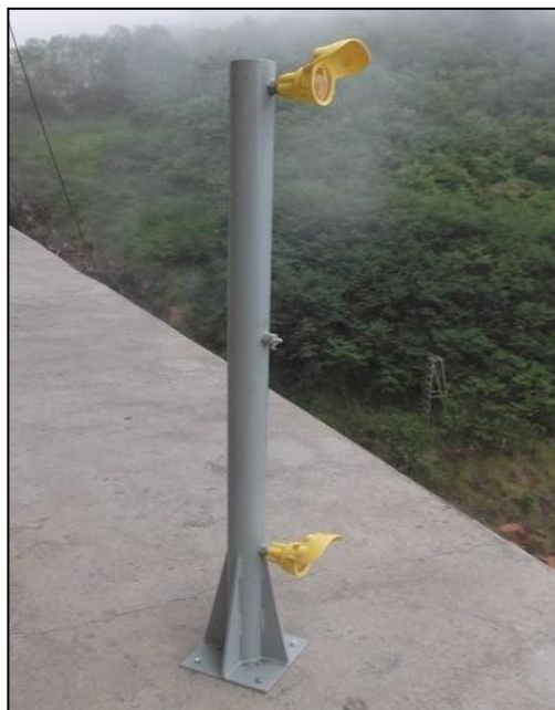
FIGURA 30 - HASTE E PRISMAS INSTALADOS NA ESCADARIA A JUSANTE DA BARRAGEM
