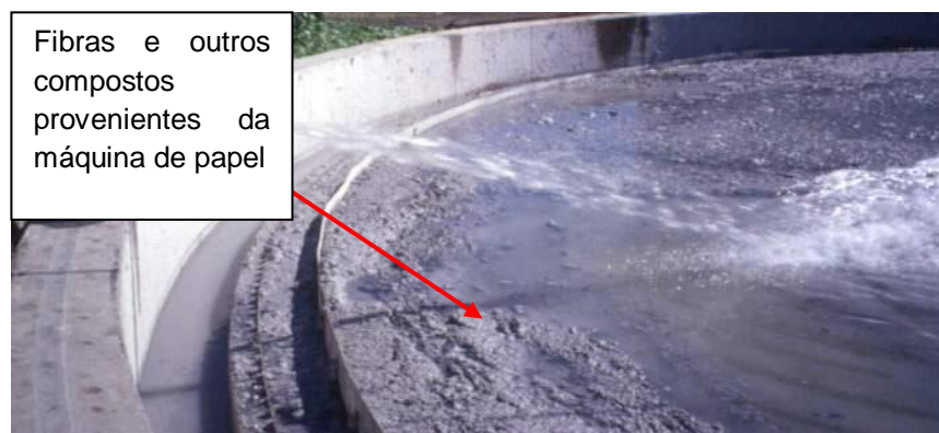
FIGURA 9 – DECANTADOR PRIMÁRIO SOBRECARREGADO DE FIBRAS CELULÓSICAS FONTE – Catálogo BELOIT
