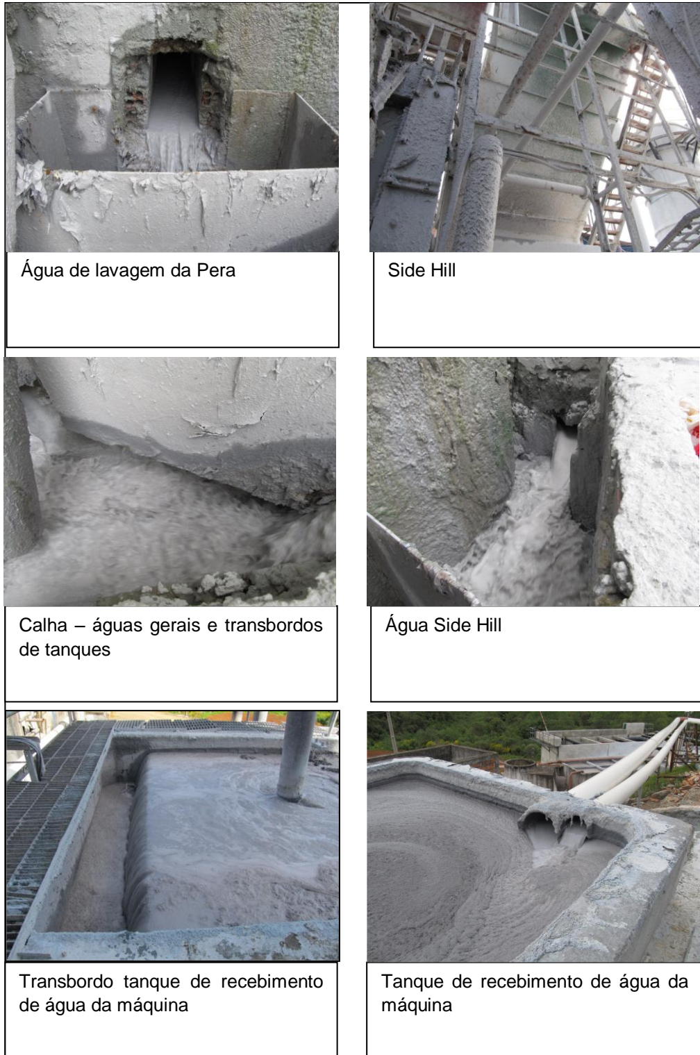
FIGURA 25 – PONTOS DE PERDAS DE FIBRAS DIRECIONADO PARA O TANQUE SUREMA FONTE: O AUTOR (2011)
