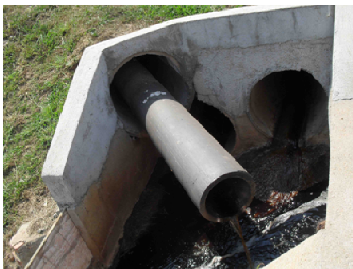
FIGURA 3.2 - EMISSÁRIO CENTRAL DO ATERRO SANITÁRIO DE CURITIBA
