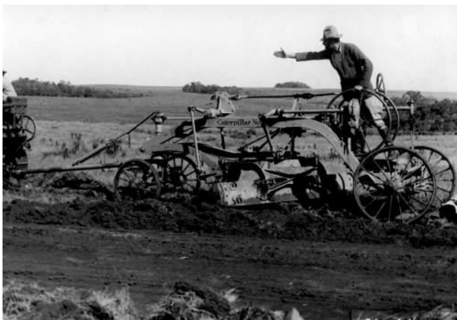
Figura 73 – Abertura de estrada em Itararé, 1927-1937. Fonte: Acervo da família de Claro Jansson – Itararé, imagem digitalizada por Paulo Moretti
