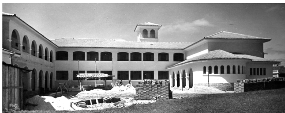
Foto 66: Pátio interno do Grupo Escolar Lysimaco Ferreira da Costa, em construção, Curitiba - sem data
