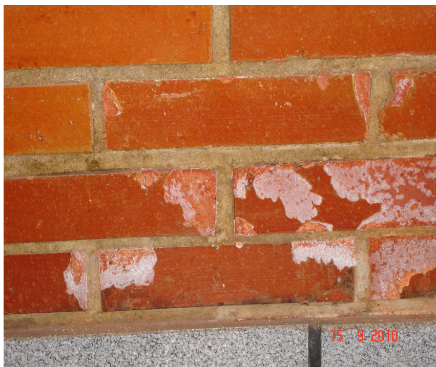
FOTO 3: EFLORESCÊNCIA CAUSADA PELA FALTA DE SAZONAMENTO NA MATÉRIA PRIMA UTILIZADA FONTE: BONATO (2010).
