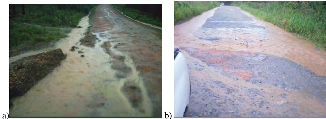
Figura 59- Fluxo de água nos margens das estradas a) Acúmulo de sedimentos nas margens das estradas após um evento. b) Processo de erosão em lençol sobre o leito da estrada, promovido devido ao acúmulo de sedimentos nas margens (valetas). Foto. Antoneli, V. (2010).
