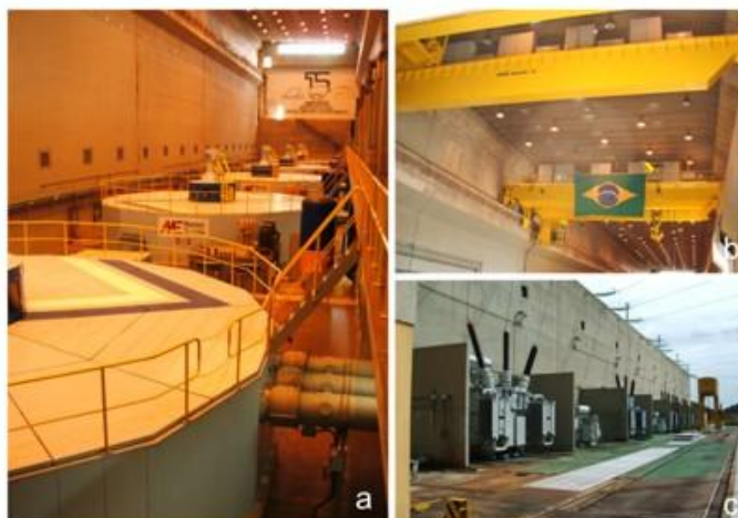
FIGURA 9 – Visão interna da UHE – Balbina. Estatores 1 a 5 (a), Guindaste de serviço que se utiliza atualmente para a manutenção dos equipamentos (b) e transformadores de voltagem, visão externa (c).
