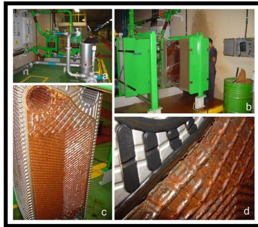
FIGURA 18 – Área dos trocadores de calor em que se encontra o ponto B de coleta conforme esquema 1. Vista geral do complexo de filtros e trocadores de calor para a unidade 2, que realiza o resfriamento do óleo lubrificante dos equipamentos da referida unidade (a), abertura do trocador de calor “Alfa Laval” de placas para manutenção e limpeza (b), visão geral do situação em que se encontra uma das placas do trocador de calor (c) e nível de acúmulo de material orgânico que se encontram as placas, observar diferença entre a parte onde passa apenas o óleo a ser resfriado (metal intacto) e parte onde passa a água do reservatório (metal com biofouling ) (d).
