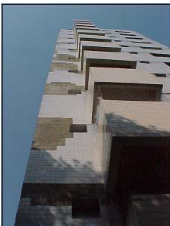
Figura 10 – Destacamento de revestimentos cerâmicos FONTE: Thomaz (1995)
