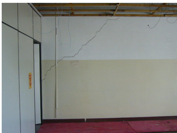
Figura 12 - Parede-1 FONTE: O autor (2009)
