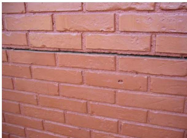
Figura 13 - Parede-2 FONTE: O autor (2009)
