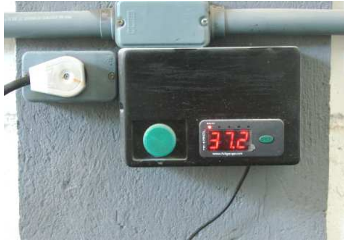
FIGURA 32 – Foto do termostato para controle da temperatura..
