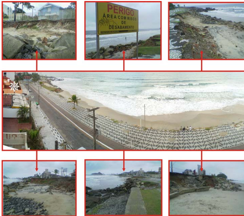
FIGURA 2 - Visão panorâmica do trecho extremo norte da Praia Brava (centro) e registro fotográfico da erosão no local (superior e inferior). Notar placa notificando a área com risco desabamento e casa próxima à área de risco.
