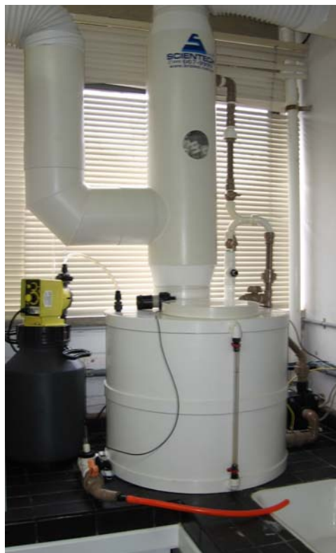
Figura 22 – Sistema de lavagem e neutralização de gases ácidos
