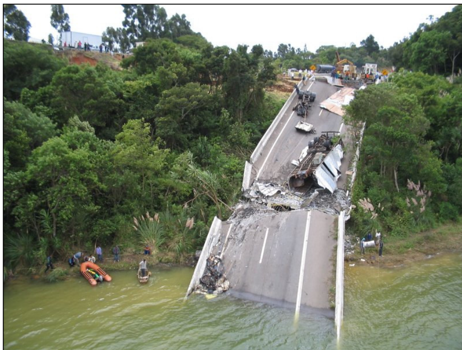
FIGURA 2 - DESABAMENTO DA PONTE DA RODOVIA RÉGIS BITTENCOURT, SENTIDO CURITIBA - SÃO PAULO
