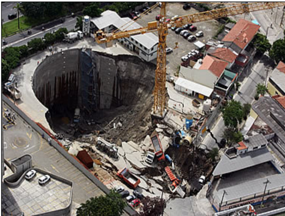
FIGURA 4 - DESABAMENTO OCORRIDO NA OBRA DA LINHA 4 DO METRÔ EM SÃO PAULO
